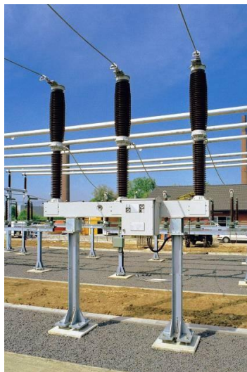
Figura 2.12: Disjuntor de Alta Tensão [25]
